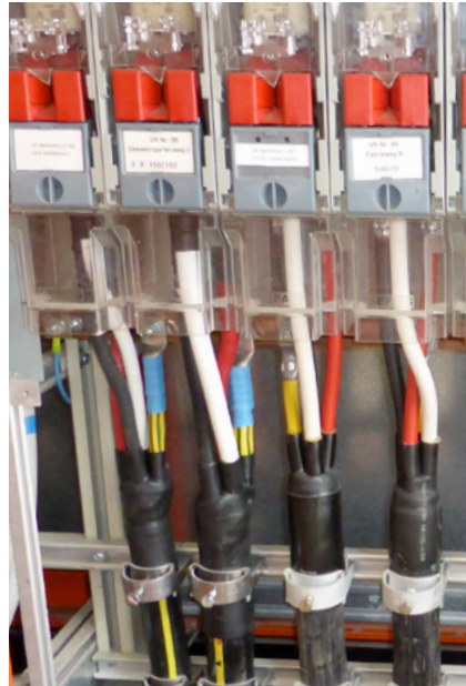
Niederspannungsverteilung einer Trafostation.
